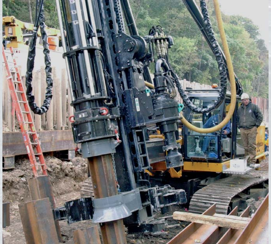
SuperRAM 6000 со специальным применением в ударном наголовнике и специальной направляющей для двойных забивных элементов, узел предварительного бурения сбоку на мачте копра
